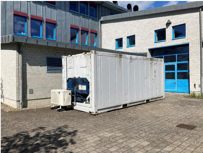
Abbildung 2 Seecontainer mit externer Kältemaschine als zusätzlicher Kühlraum, hinter dem Kühlcontainer ist die eine Zuluftöffnung des Kältemaschinenraumes zu erkennen
