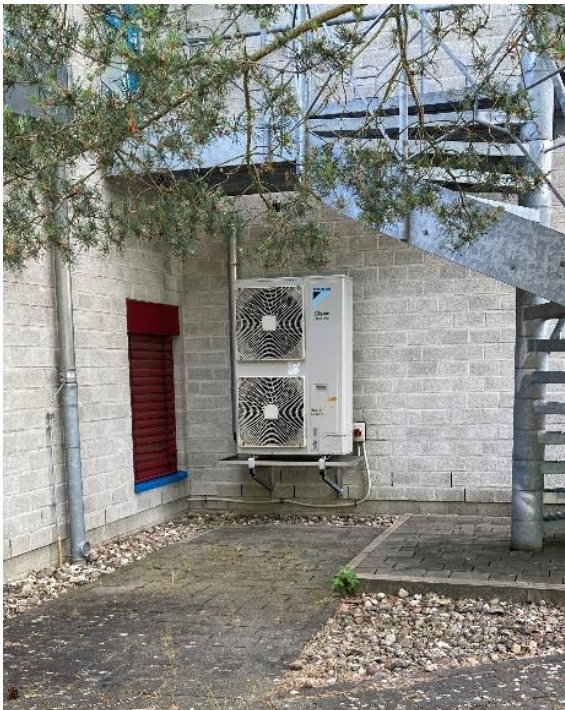
Abbildung 4 Außeneinheit zur Klimatisierung
