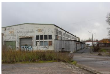
Leerstehende Gewerbehalle in baufälligem Zustand im südlichen Bereich. Derzeit fehlt es neben einer inneren Erschließung an einer attraktiven Gebietsgestaltung.
